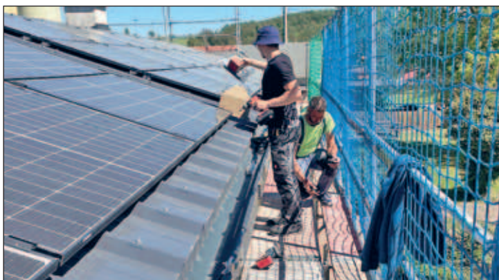
Auf dem Gebäudedach des Freibads wurde eine Photovoltaikanlage installiert.
