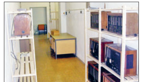
Der bescheidene Anfang im ehemaligen „Stern-Gebäude“: Arbeits- und Lagerraum im Raum der Batterieanlage
