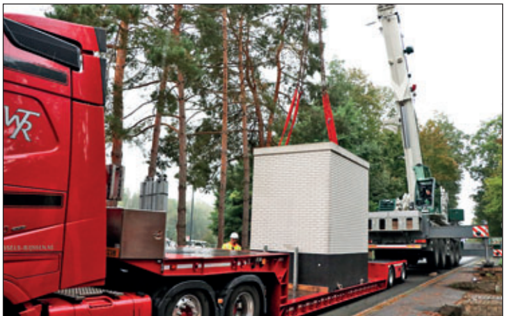
Schnelles Internet für Rochlitz, Seelitz und Zettlitz – Hauptverteiler wurde an der Zaßnitzer Straße installiert.
