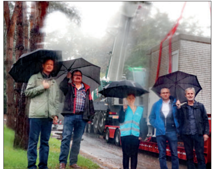
Bei strömenden Regen erfolgte mit einem Autokran die Aufstellung des Hauptverteilers zum Breitbandausbau an der Zaßnitzer Straße. Der sogenannte PoP ist das Herzstück für die geplante Erweiterung des Glasfasernetzes in Rochlitz, Seelitz und Zettlitz. Im Bild (v.l.n.r.): Alexander Schramm, Koordinator Breitbandausbau im Bauamt der Stadtverwaltung Rochlitz; Uwe Buttgeriet, Mitarbeiter Bauamt Rochlitz; Jana Katharina Bayer, Programm-Managerin Förderung von der Deutschen Glasfaser Wholesale GmbH; Steffen Dathe, Bürgermeister Gemeinde Zettlitz; Thomas Oertel, Bürgermeister Gemeinde Seelitz
