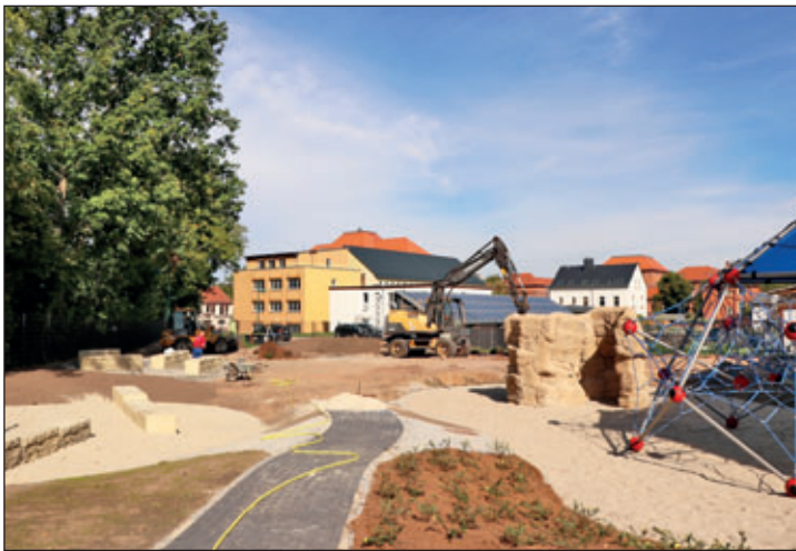
Bei dem 2.000 Quadratmeter großen Außengelände stehen die Gestaltungsarbeiten unmittelbar vor dem Abschluss.
