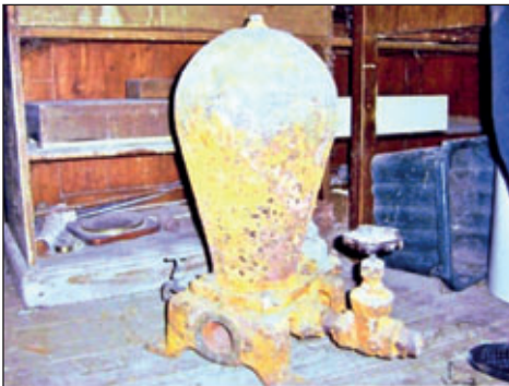
Stillgelegter Wasserwidder, Eigentümer Agraringenieur Gottfried Müller, Nöbeln bei Rochlitz/ Foto: Klaus Dehne, Rochlitz 2007/
