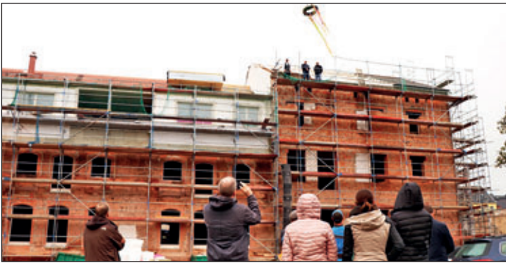
Richtfest am Wohngebäude „Alte Brauerei“. Laut Angaben des Investors, der Fa. Golz Wohnbau GmbH ist die Fertigstellung des Gebäudes für Mitte 2021 avisiert.
