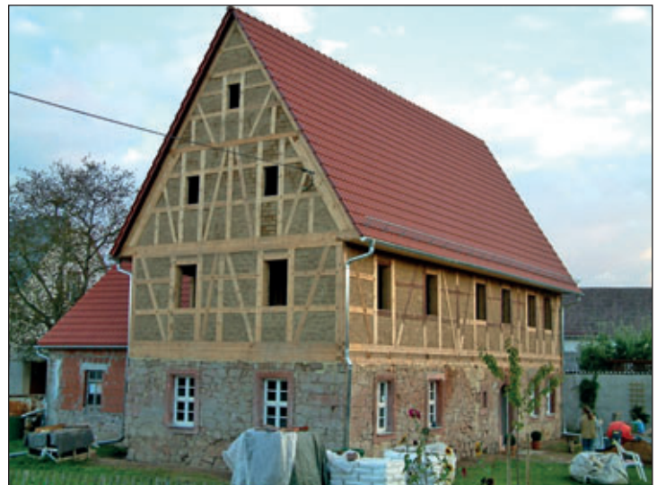
Sanierung des „alten Gasthofes“ Der alte Gasthof war später nur Wohnhaus und zwischenzeitlich eine Konsumverkaufsstelle; fach- und denkmalgerecht saniert 2002-2004 von Maria und Mike Speer; Bildquelle: W&R Richter, Noßwitz 2003 während der Sanierung
