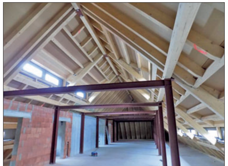
Dachgeschoss: hier könnte eine Dauerausstellung des Vereins Fürstentzug zu Dresden e.V. mit Kostümen und Requisiten eingerichtet werden.
