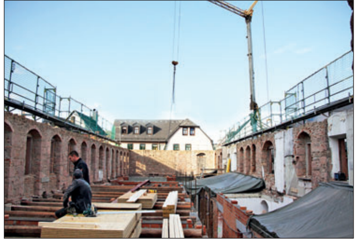
Bauliche Sanierung der Stadtbibliothek: Nach der kompletten Entkernung sind mittlerweile alle Decken neu errichtet – der Dachstuhl soll noch im Dezember gestellt werden.
