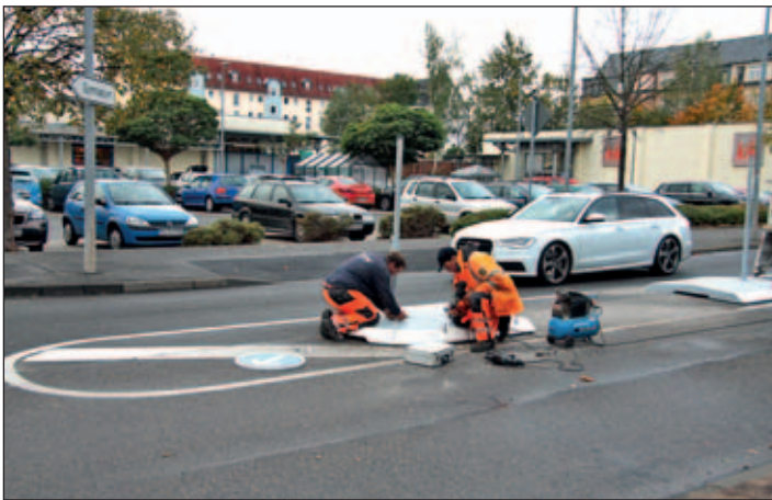
Mitarbeiter der Fa. Verkehrsleitsysteme Döbeln GmbH beim Montieren einer neuen Mittelinsel auf der Rochlitzer Poststraße.
