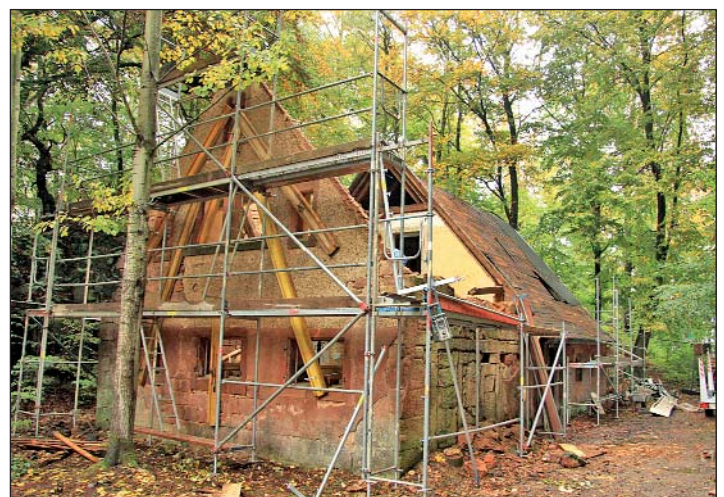
Einer Forderung der Unteren Denkmalschutzbehörde beim Landratsamt Mittelsachsen nachkommend, hat die Stadt Rochlitz Notsicherungsmaßnahmen in Höhe von 25.400 Euro zur Erhaltung der Alten Schmiede auf dem Rochlitzer Berg veranlasst.
