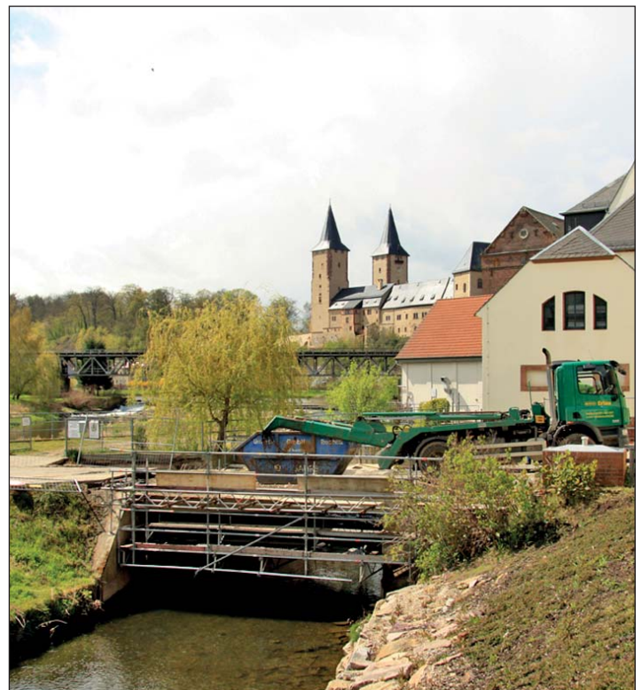
Am 18.04.2016 war Baubeginn der Brücke Zufahrt Insel. Ausführender Betrieb ist das Unternehmen HTB GmbH Rochlitz. Während der Bauzeit bleibt die Brücke für den Verkehr gesperrt. Fotos: J. Richter
