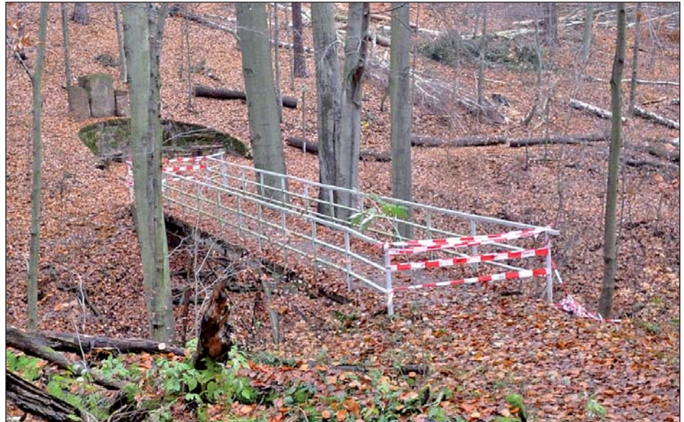
Marode Mordgrundbrücke unmittelbar vor ihrem Abriss (Archivbild Jörg Richter)
